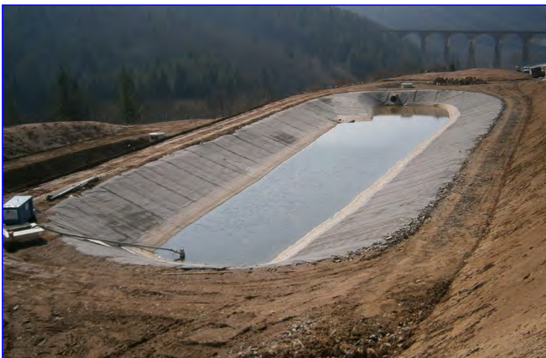
Balsas, A89, Lyon (Francia) - 91 000 m 2 HIDRAULICA / Balsa
