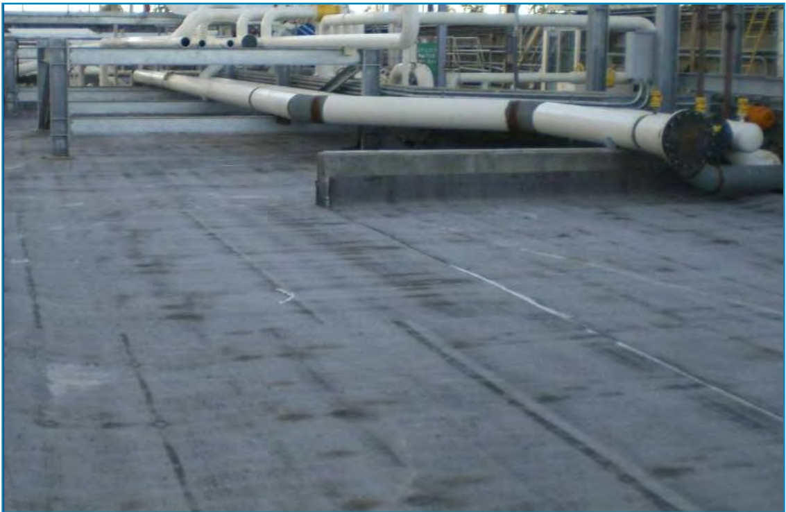
Retención secundaria de carburante, Portland (USA) - 4 080 m 2 MEDIOAMBIENTE / CONFINAMIENTO
