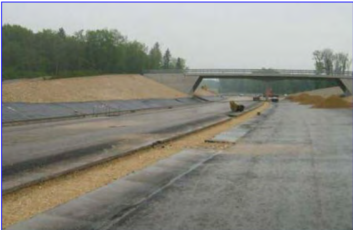
Fosas de cunetas, N1019, Boncourt (Suiza) - 16 000 m 2 TRANSPORTE / CARRETERAS
