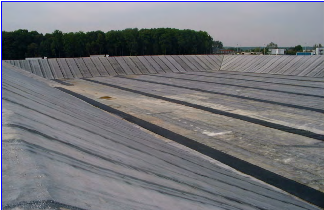
Balsa de retención de una azucarera, Etrepagny (Francia) - 63 000 m 2 MEDIOAMBIENTE / RESÍDUOS LIQUIDOS
