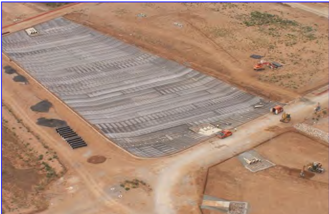
Balsa, Narbonne (Francia) - 30 000 m 2 HIDRAULICA / Balsa
