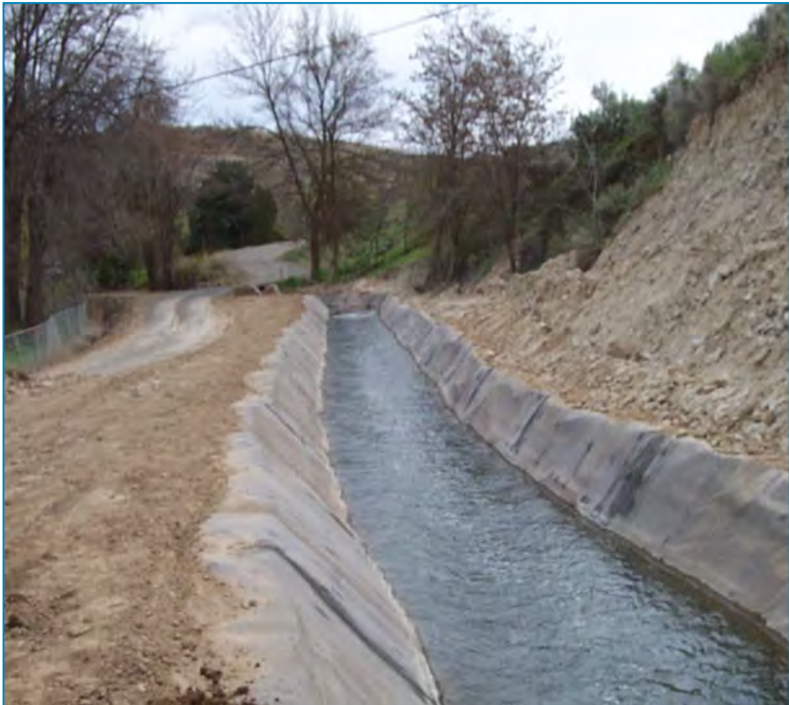
Canal, Yakima (USA) - 7 800 m 2 HIDRAULICA / CANALES
