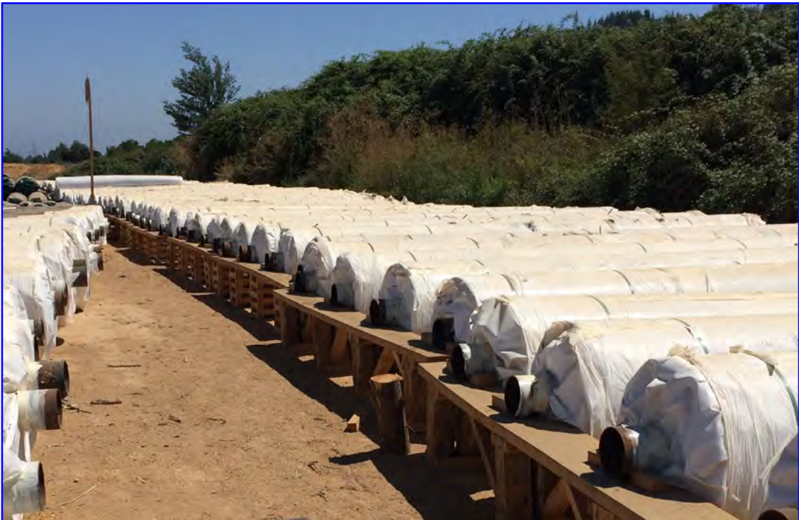
Canal Cumpeo de Unión de una central eléctrica (Chile) - 65 178 m 2 HIDRAULICA / CANALES
